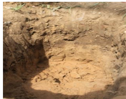
Gambar 2 Struktur tanah pada kawasan pemukiman Pulogangsa
