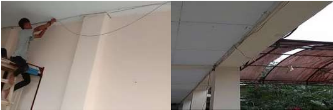
Gambar 5. Proses pengaturan instalasi listrik yang tidak beraturan.
