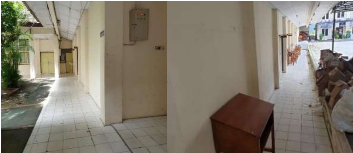
Gambar 2. Dinding Ruang Kuliah yang sudah terlihat memudar dan kotor. (Dokumentasi Tim)
