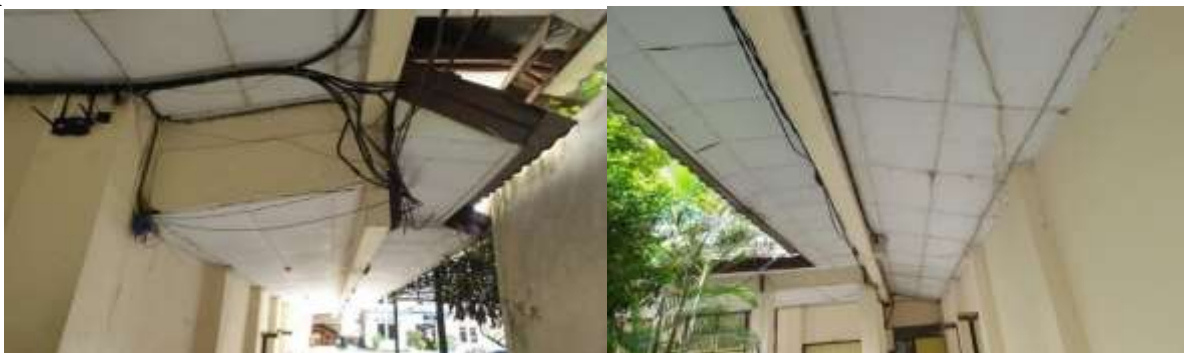
Gambar 3. Jaringan Instalasi Listrik Yang Tidak Beraturan. (Dokumentasi Tim)
